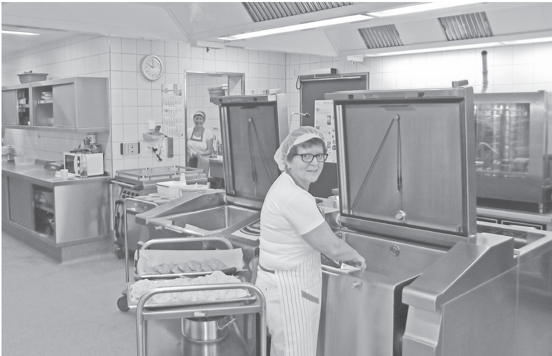
Herzstück des generalsanierten Seniorenheimes in Berching ist die Küche. Sie ist mit modernster Technik ausgestattet.
